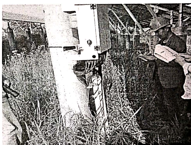
核查光伏 3 区安装容量
