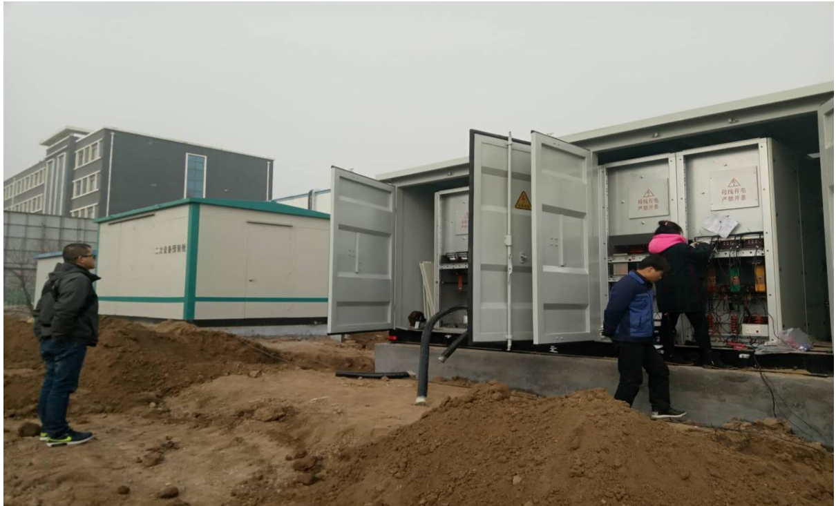
2017.12.30 一次设备预制舱内接线，业主巡视现场
