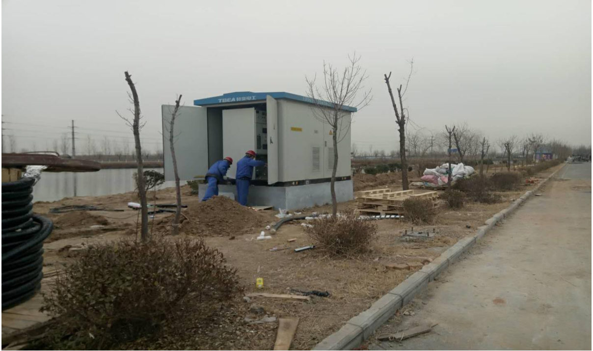
2018.01.07 四号箱变内接线
