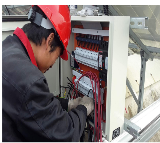
光伏区 6#厂房屋顶汇流箱内接线
