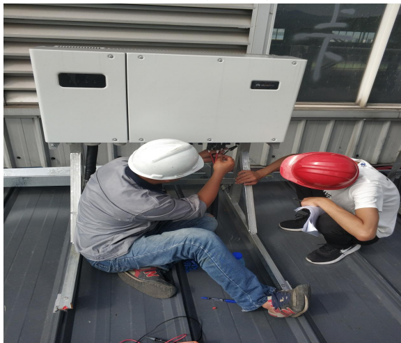
组串开路电压检测
