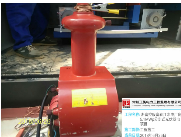
箱变耐压测试
