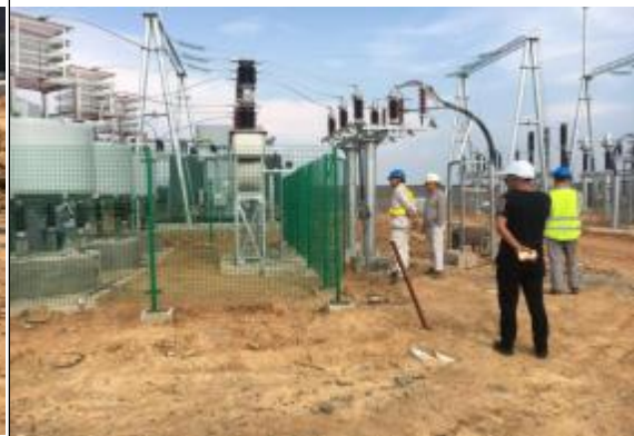
升压站现场缺陷检查
