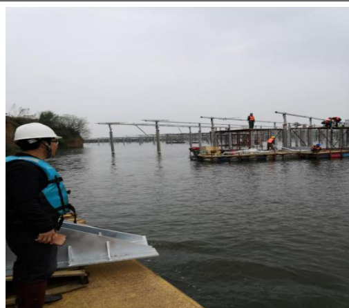
对光伏区进行巡视检查
