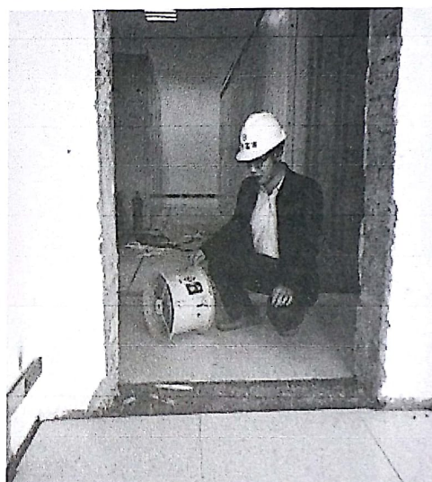
配电楼风机设备检查
