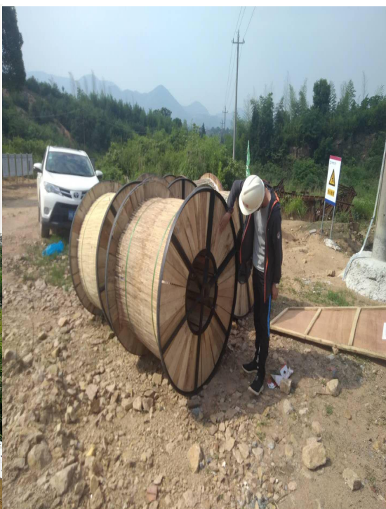
升压站电缆查看
