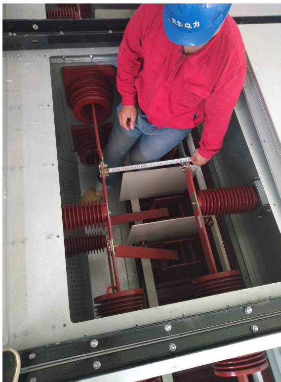
升压站开关柜母排检查
