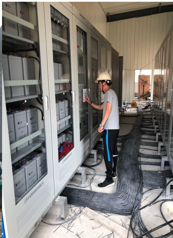
升压站二次设备检查
