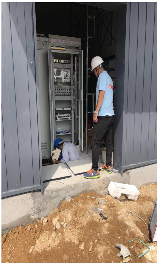
升压站设备检查
