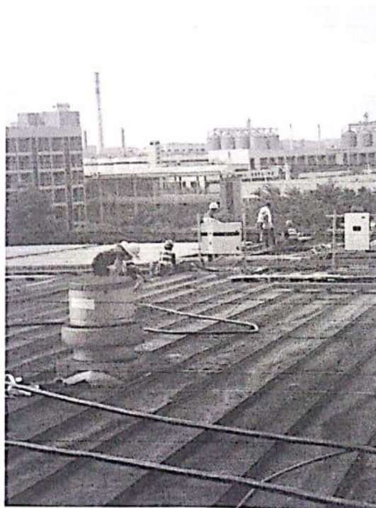
交流电缆敷设
