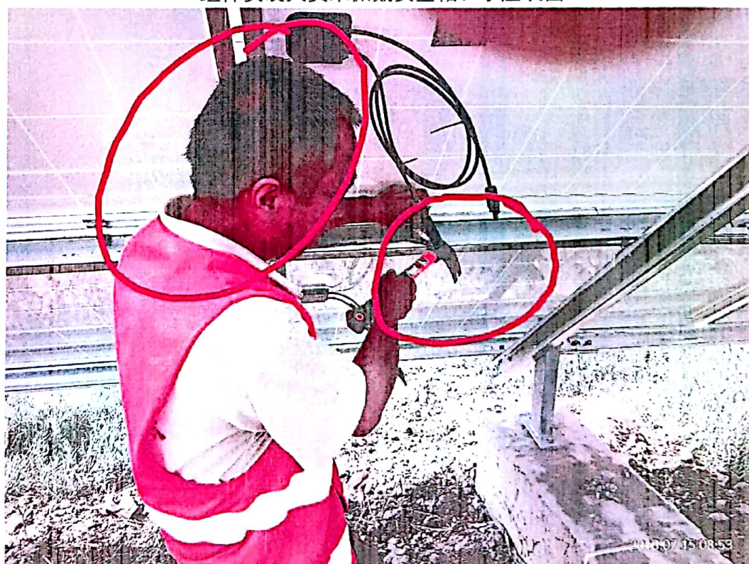
组件安装人员未佩戴安全帽、铁锤调整中垫片组件
