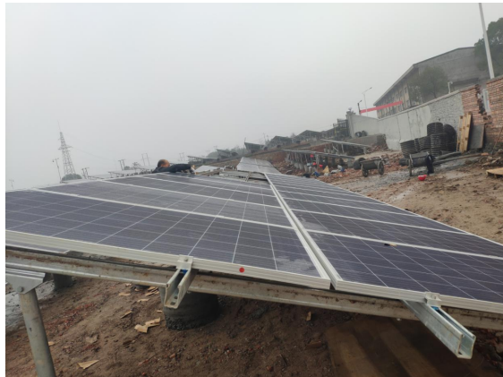
机械区安装组件
