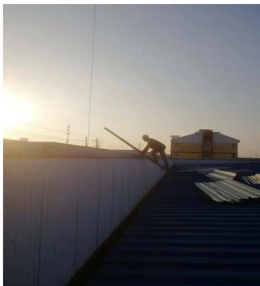
施工人员搭设扶梯攀爬女儿墙
