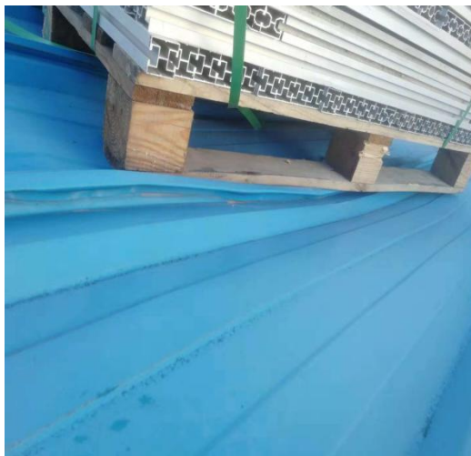
集中吊装导致屋面变形
