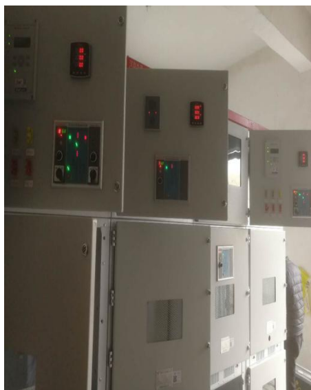
高压设备通电
