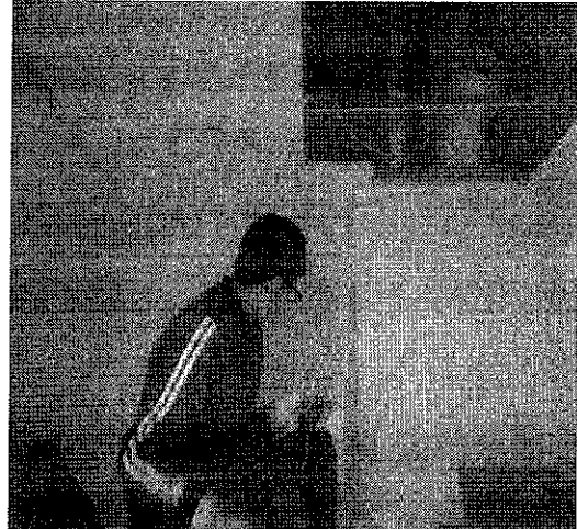
4、现场施工作业未戴安全帽
