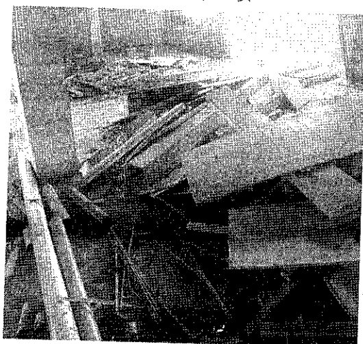
文明施工做的不到位
