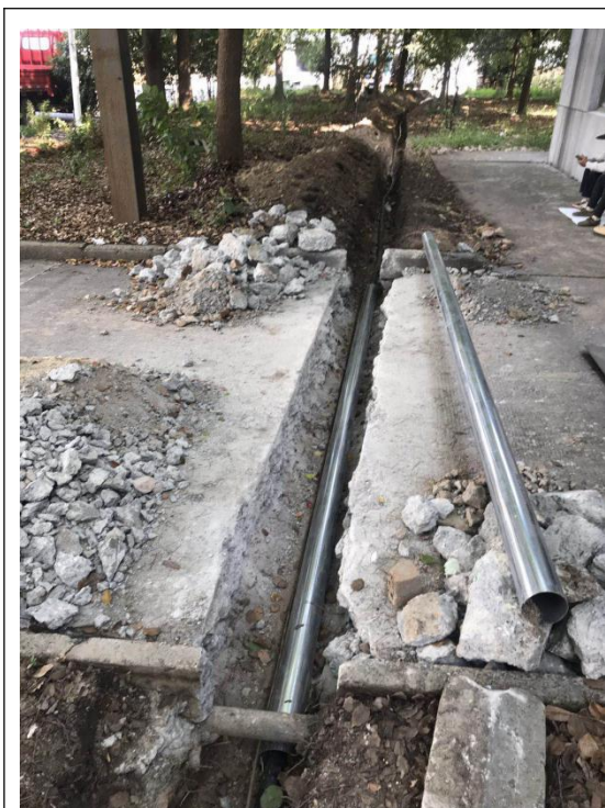
交流电缆过路埋管
