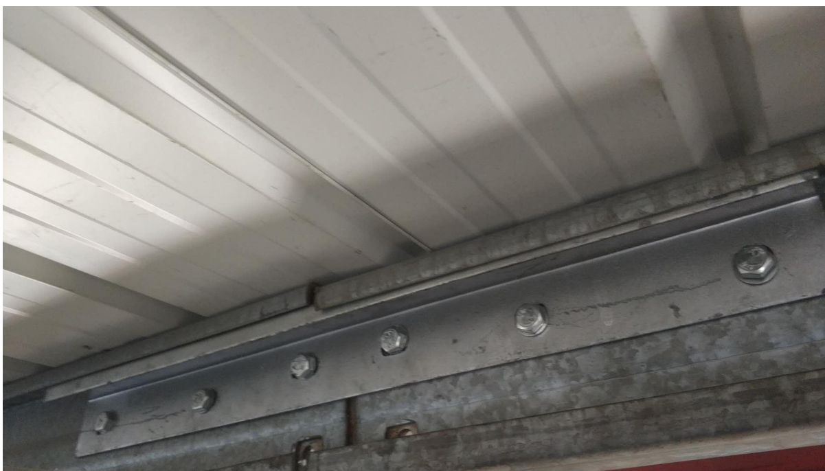
结构加固標条漏装
