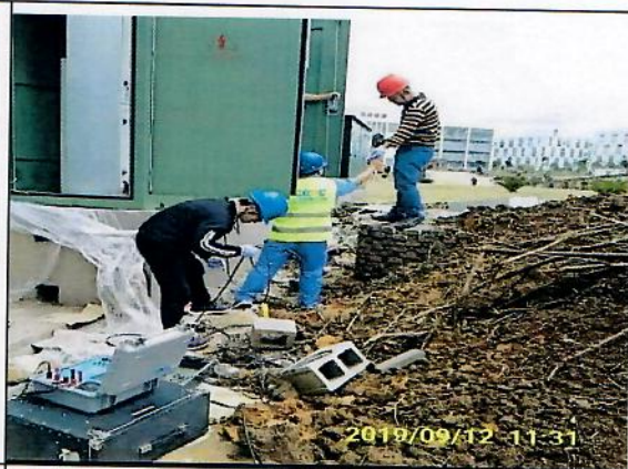
环网柜交接试验
