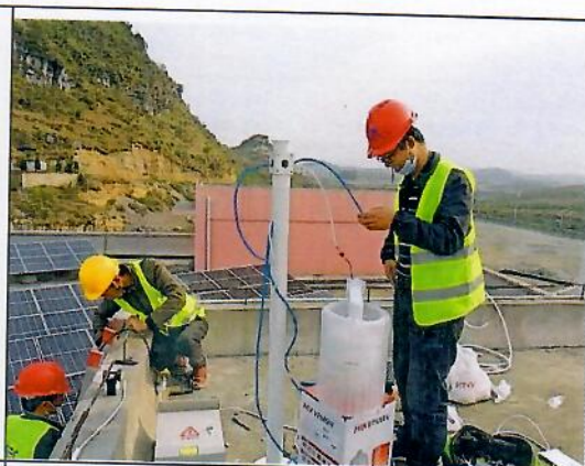
安装监控视频
