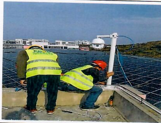
安装监控视频
