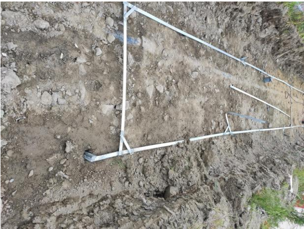
设备基础接地
