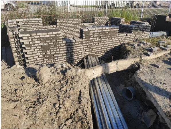
逆变器输入线管
