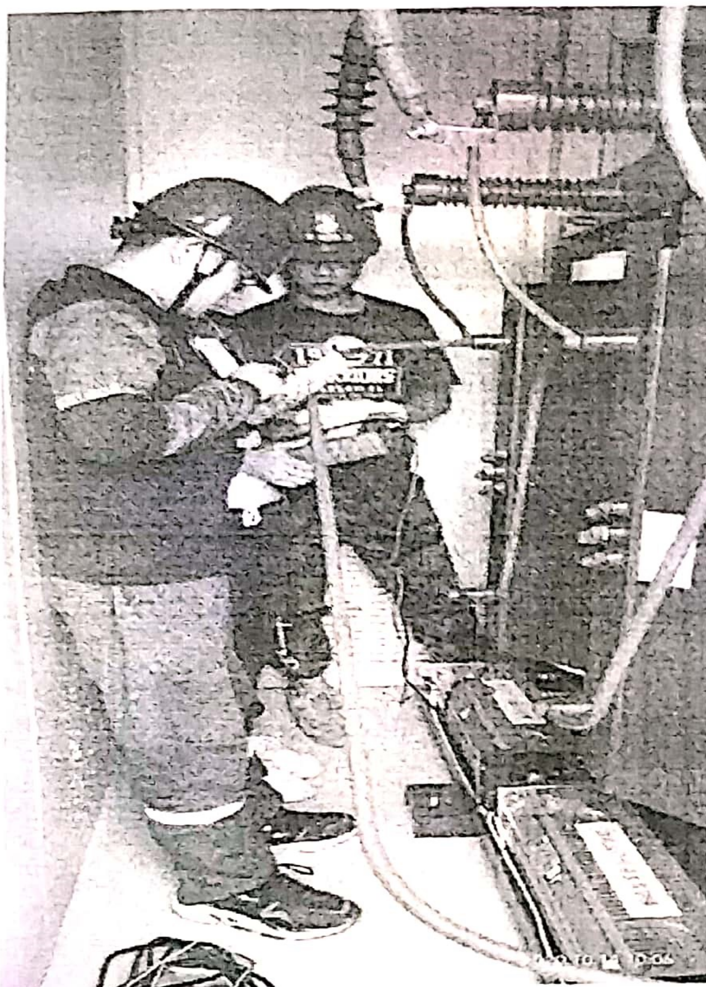
现场 91#、93#、94#箱变变比、直阻测量 和绝缘试验测试
