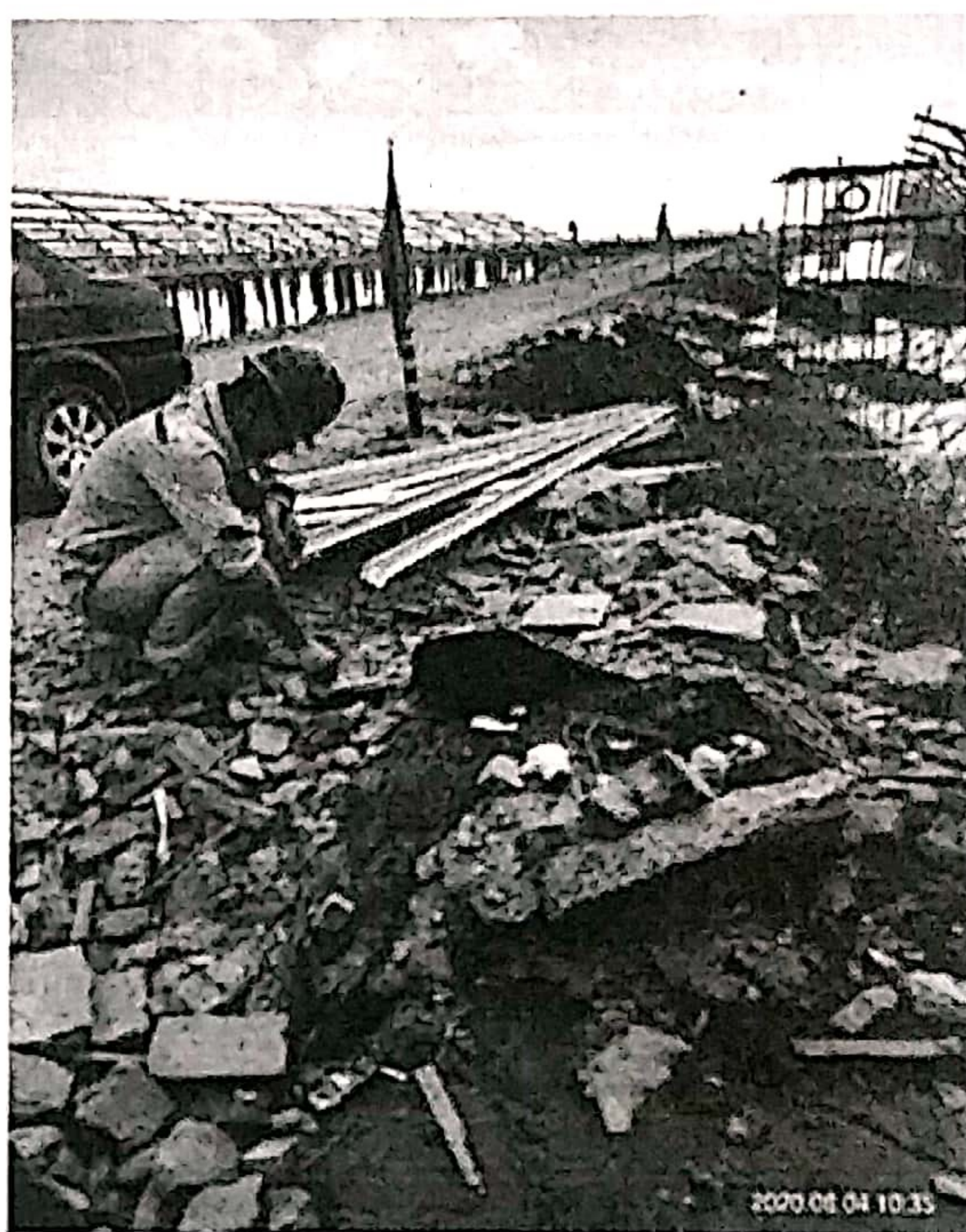
测量 27#箱变接地电阻
