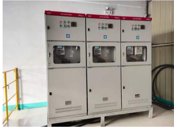
光伏交流并网柜并网试运行
