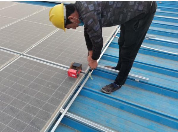
南和厂区接地线固定
