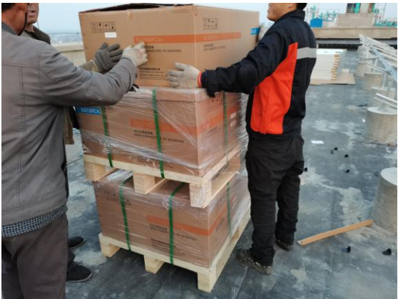
南和厂区逆变器开箱检查
