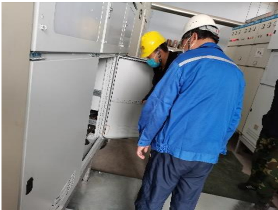
沙河厂区配电房并网柜检查
