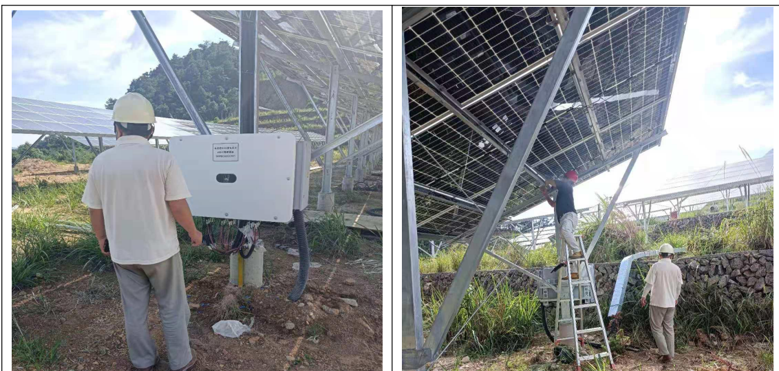
对龙须区直流电缆线消缺进行检查
