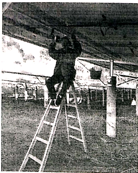
23#区组件间接地线连接
