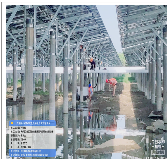
一标段光伏区逆变器消缺
