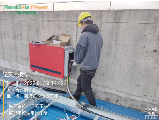
光伏逆变器接线
