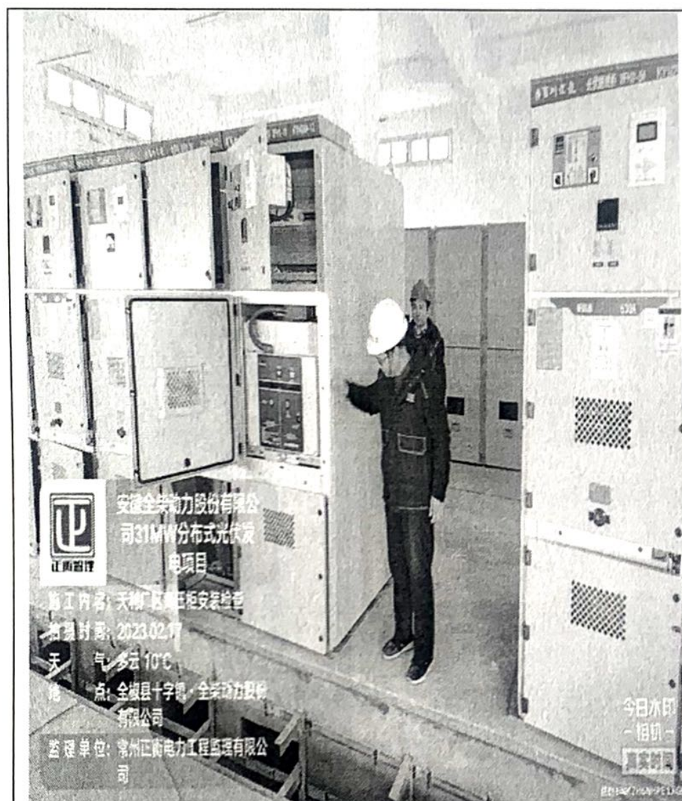
天利厂区高压柜安装检查
