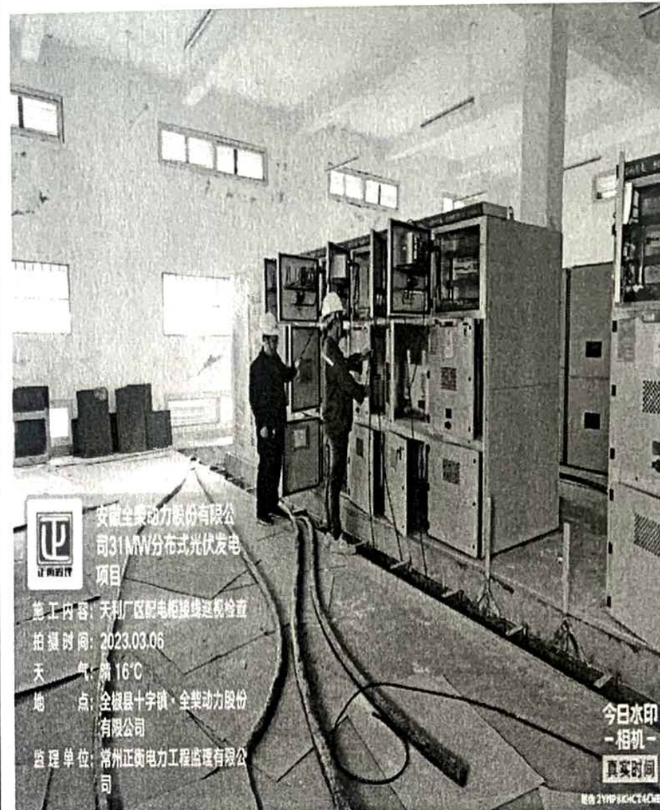
天利厂区配电柜接线巡视检查
