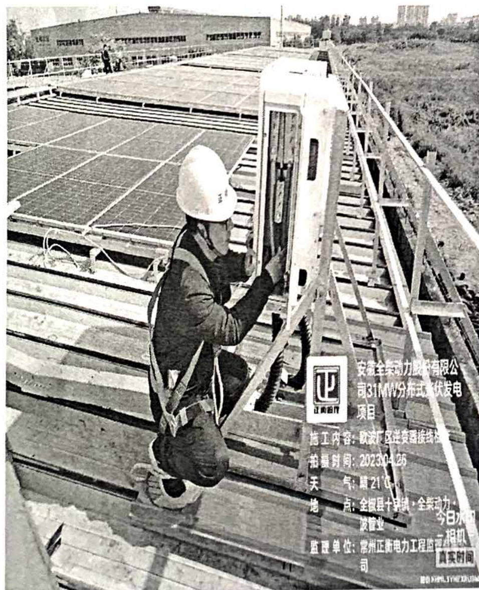
欧波厂区逆变器接线检查
