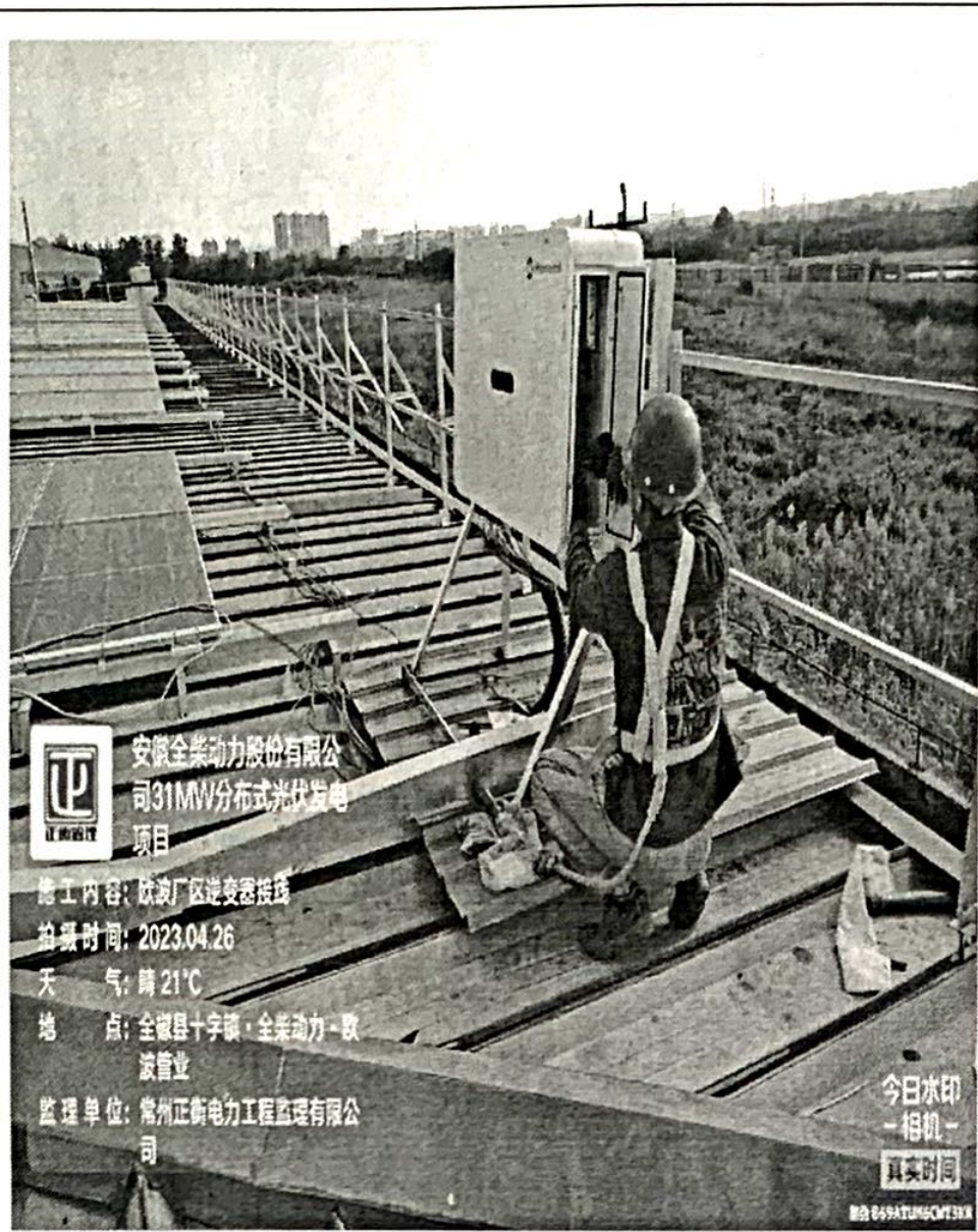
欧波厂区逆变器接线
