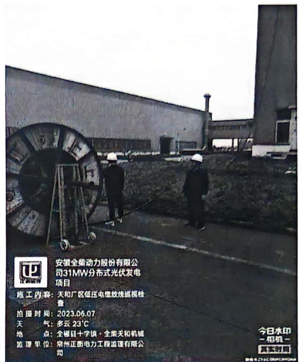
天和厂区低压电缆放线巡视检查
