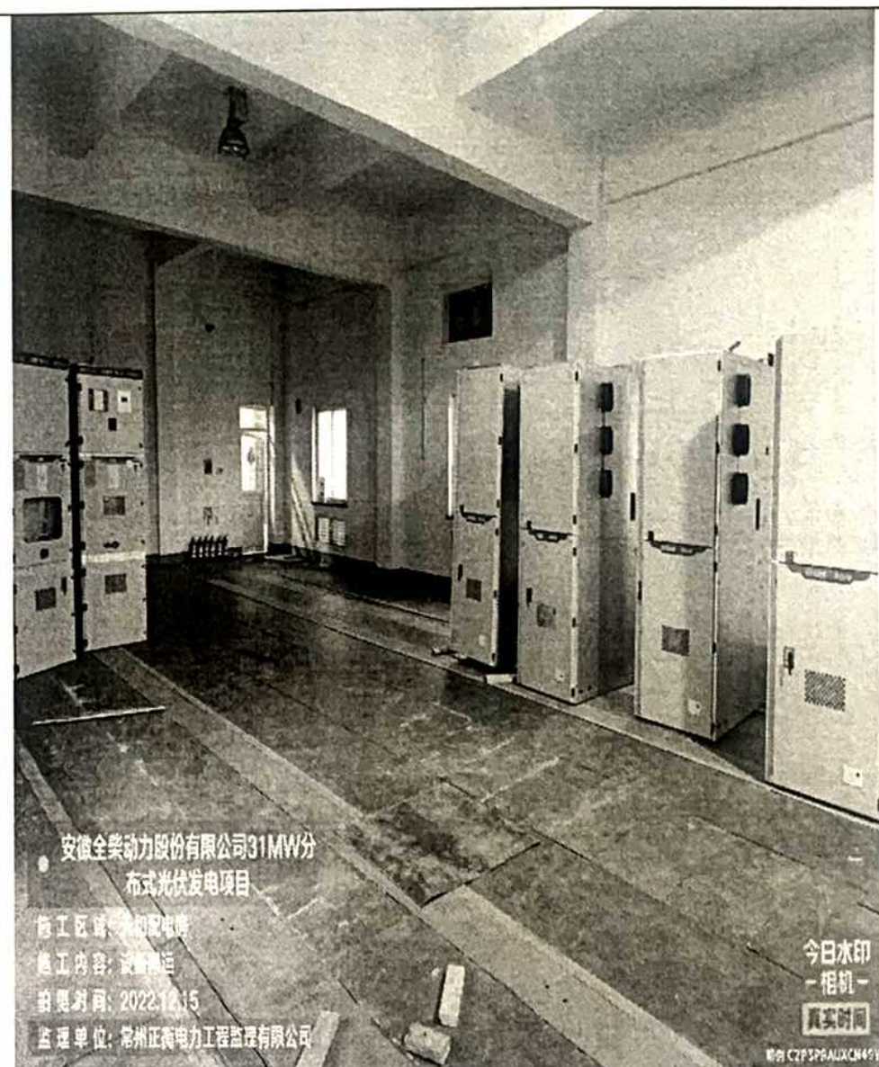
天和配电柜就位
