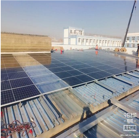
廊坊大厂和平铝业分布式光伏发电项目
