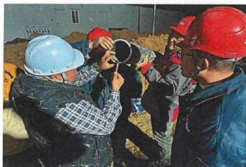
升压站消防管网验收
