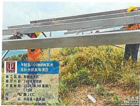
阳朝区域 24#地块支架消缺
