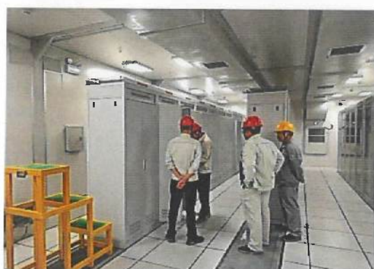
升压站巡视检查
