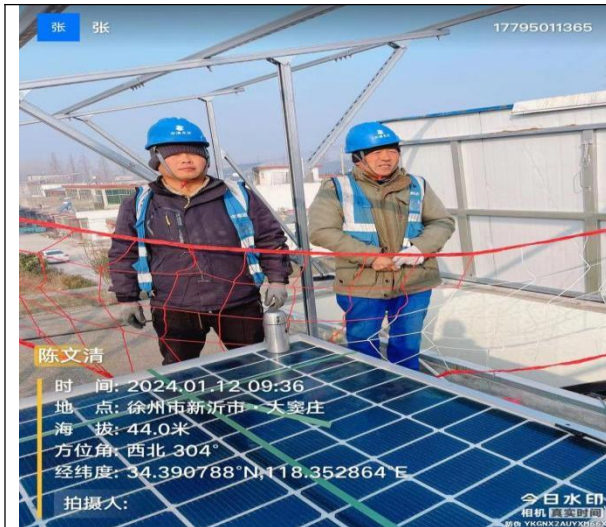
现场临时用电
