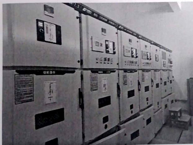
高压盘柜控制装置送电
