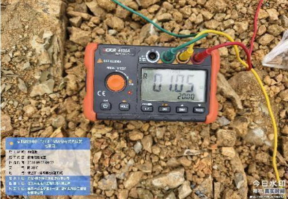
4#车棚接地电阻检查
