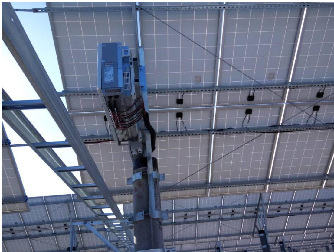
3、已完成接线逆变器
