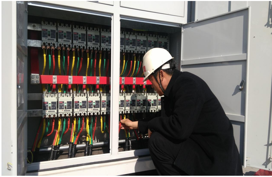
1、查看箱变低压侧接线
