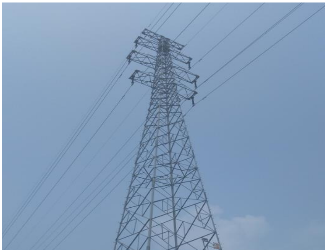
图 6.3-1 线路 T 接杆塔（092 号）
