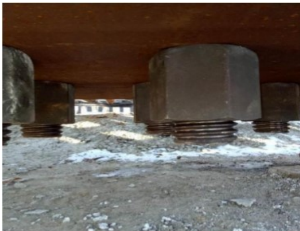
图 3.34 锚栓下端螺母外露丝扣
